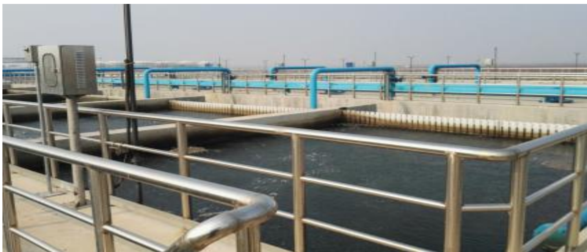
图 4.1.1-8 曝气生物滤池
