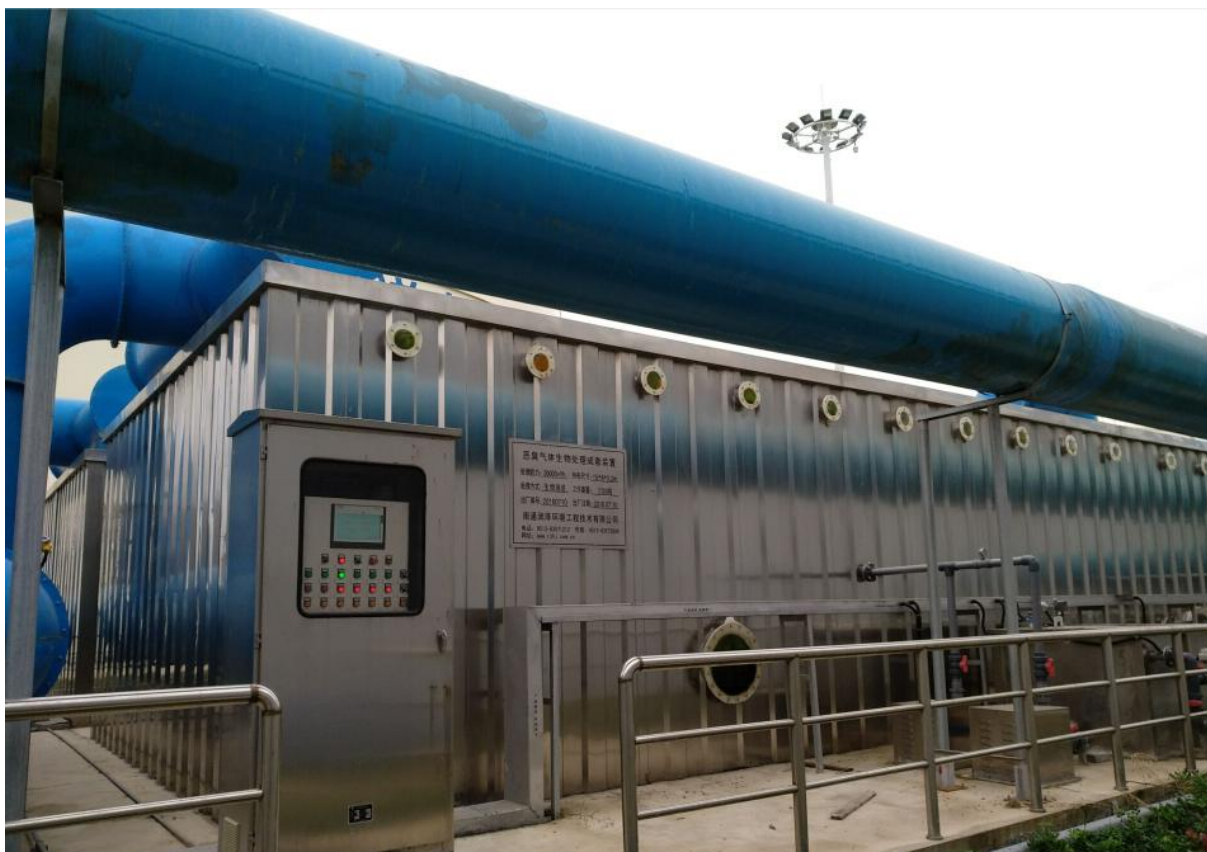
图 4.1.2-1 生物除臭装置
