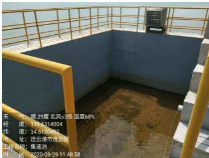
图 3.3.2-1 2#集液池现场照片
